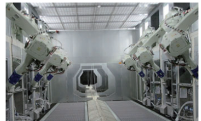
塗装プラント (ブース内)
