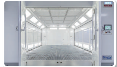
塗装プラント (塗装ブース)
