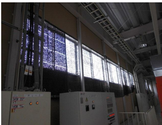
工場空調室の窓ガラスに遮光ネット
